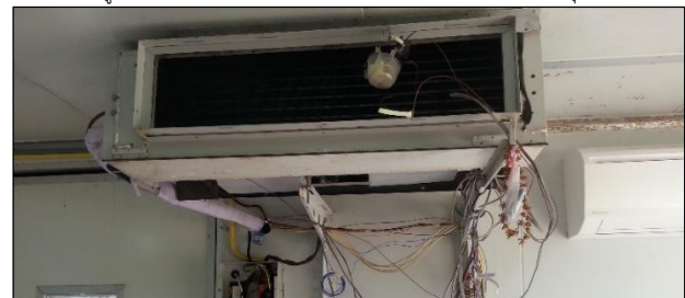
รูปที่ 4 Fan coil unit ของชุดทดสอบ
